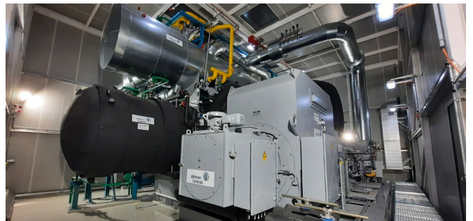
Dank einer CO 2 -Einsparung von rund 15.000 Tonnen jährlich leistet das Projekt einen wichtigen Beitrag zur Dekarbonisierung der Region Stuttgart. (Bild: Johnson Controls)
