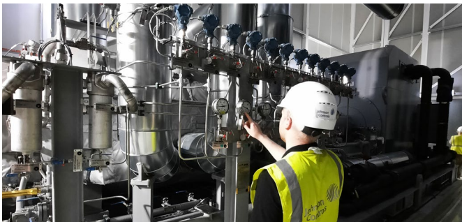
Die individuell konzipierte Anlage entzieht dem aus dem Neckar stammenden Kühlwasser effizient Wärme zur klimaneutralen Fernwärmeerzeugung. (Bild: Johnson Controls)
