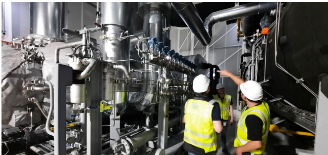
Mit einer Leistung von bis zu 24 MW erzeugt die Großwärmepumpe seit April 2024 klimaneutrale Fernwärme für rund 10.000 Haushalte. (Bild: Johnson Controls)
